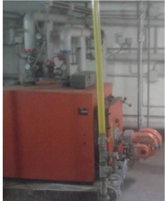
Figura 8.5 – Particolare della caldaia
