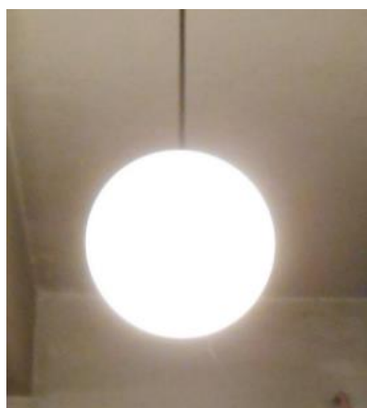
Figura 8.8 – Particolare di un corpo illuminante
