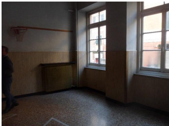
Figura 4.6 – Particolare dei radiatori
